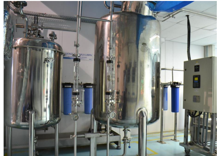
Filtração microbiológica e sistema em looping.
