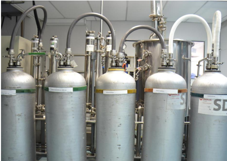
Sistema de tratamento de água para enxágue.
